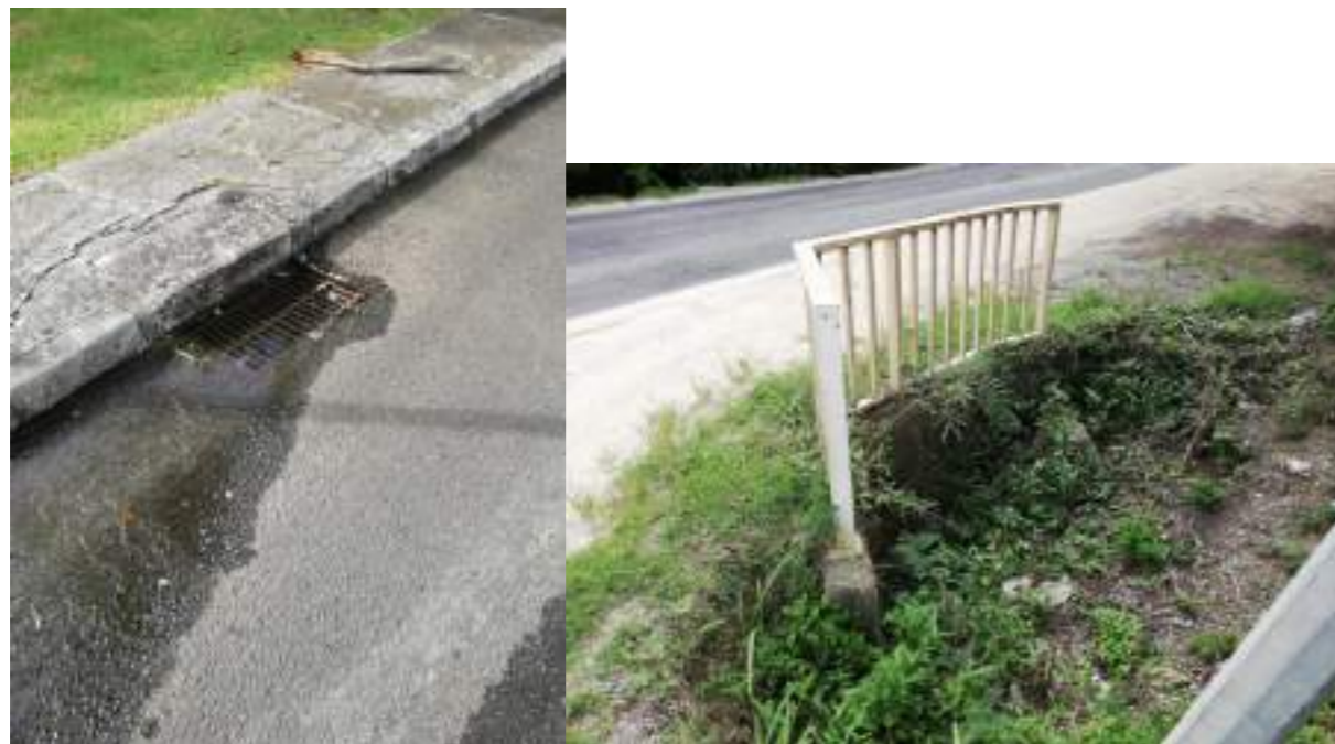
FIGURE 112 : OUVRAGES DE COLLECTE DES EAUX PLUVIALES PRESENTS LE LONG DE LA RD118 (EGIS, OCTOBRE 2020)
