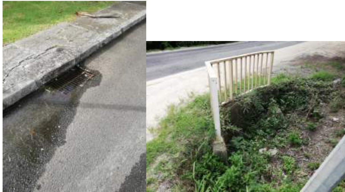
Figure 27 : Exemple d'ouvrages de collecte des eaux pluviales présents le long de la RD118
